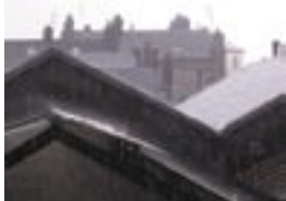
Les fortes pluies de Floque
