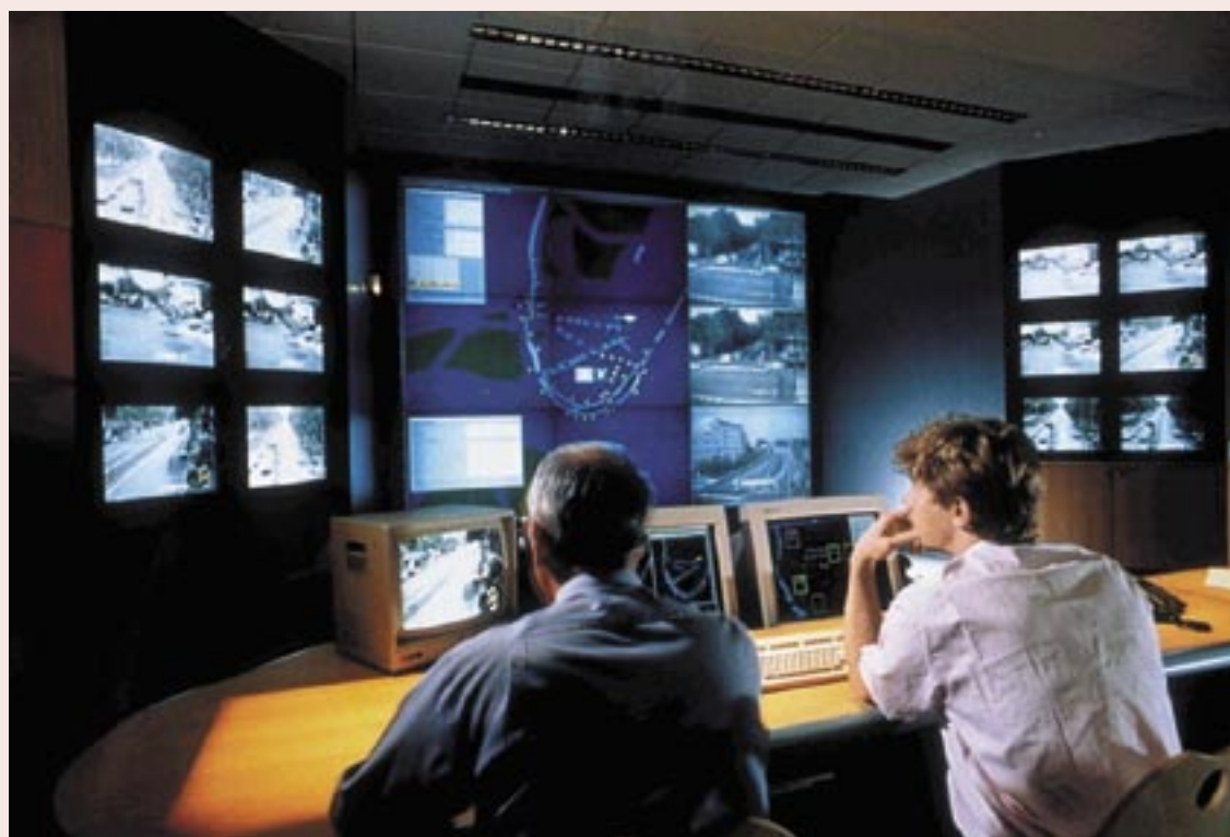
Selon les termes du contrat de partenariat, un poste de contrôle (PC) de la circulation sera installé rue Orbe.
